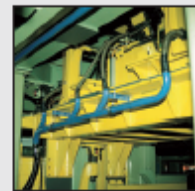
Saugrohrleitung mit 4 Saugstellen incl. Saugdüsen an autom. Stanze, Karosseriefertigung
